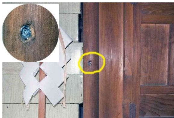
外側の板壁を貫通してご神体をお祀りする内陣の柱に弾痕
